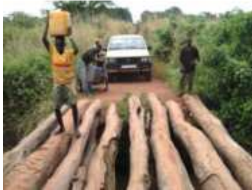
Figure 1: Photo d'un pont infranchissable par les véhicules de moins de 2,5 tonnes (route de Mala)
